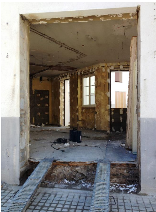
Perspective sur le hall d'accueil... « En route vers les bureaux désirables ! » (Chantier au 22 octobre)
