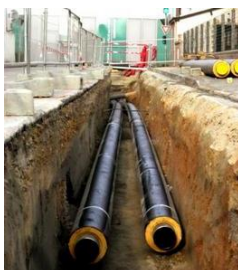
Réseau de chaleur
